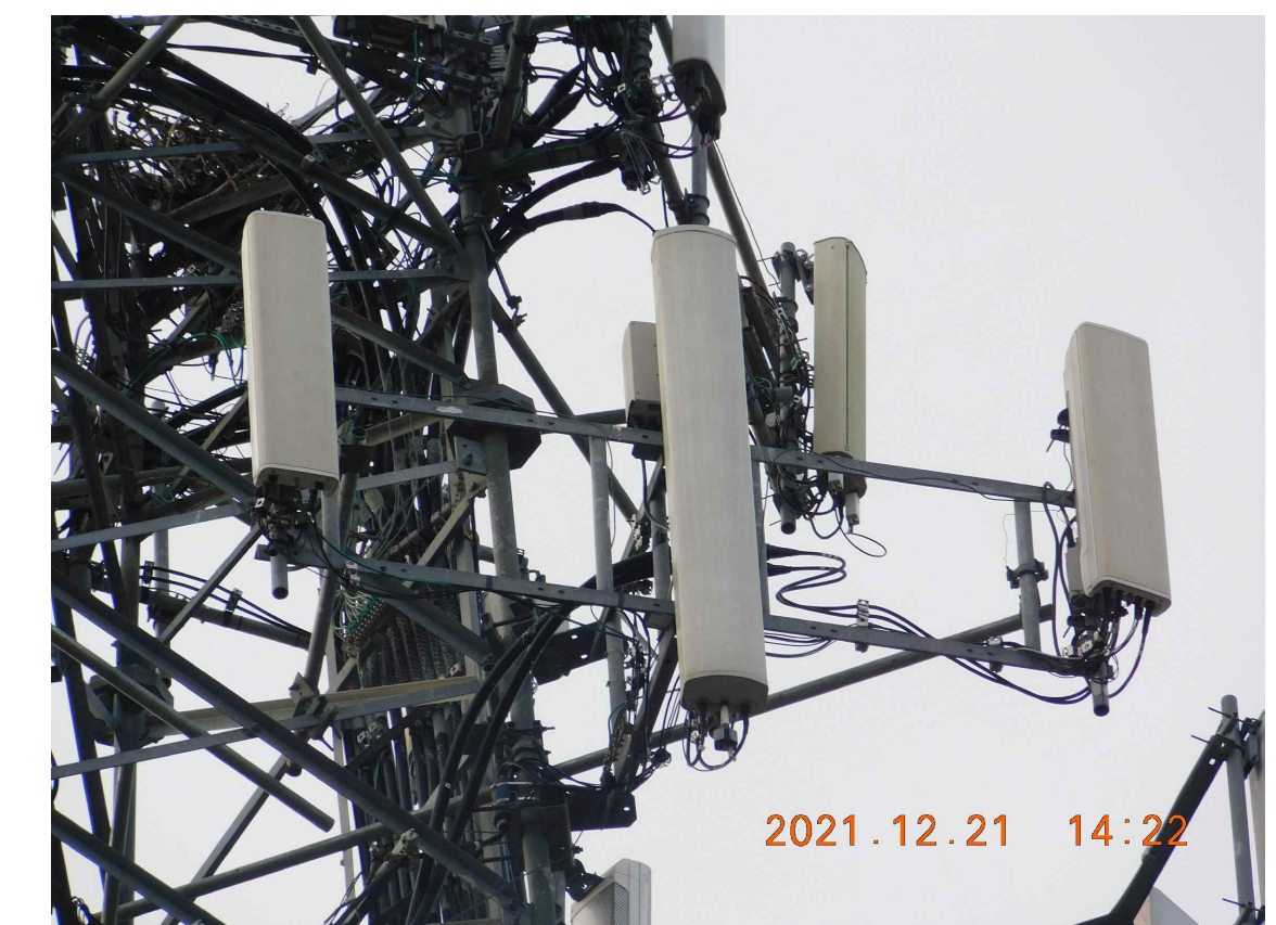
EXISTING ANTENNA PHOTO 3 SCALE: N.T.S.
