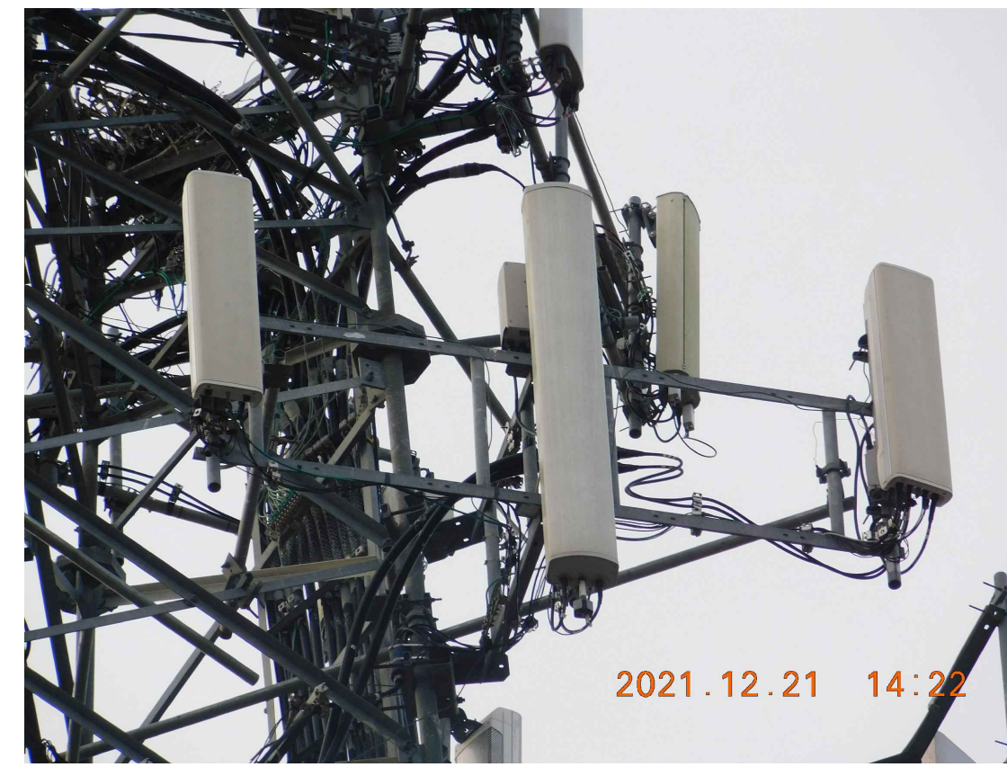
EXISTING ANTENNA PHOTO 3 SCALE: N.T.S. A-2
